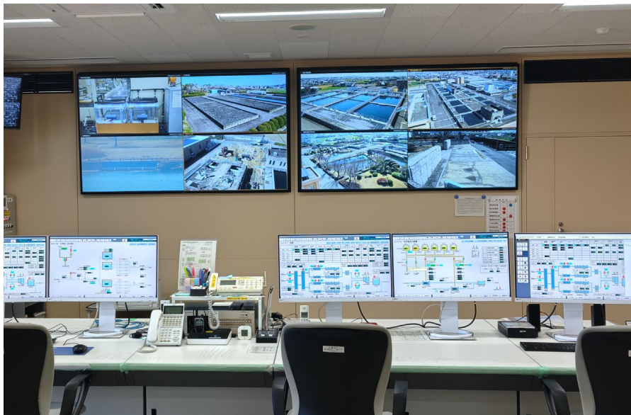
中央監視制御装置（監視操作卓、大型モニター）
