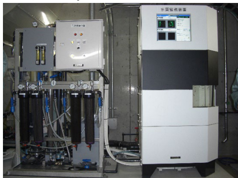
魚類監視装置
