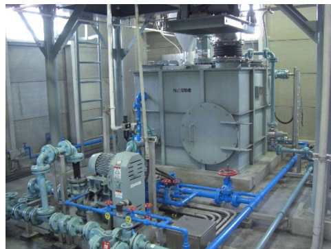
粉末活性炭注入設備
