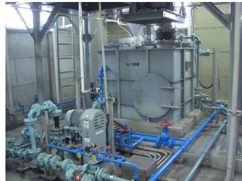
粉末活性炭注入設備
