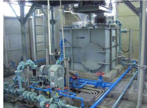
粉末活性炭注入設備
