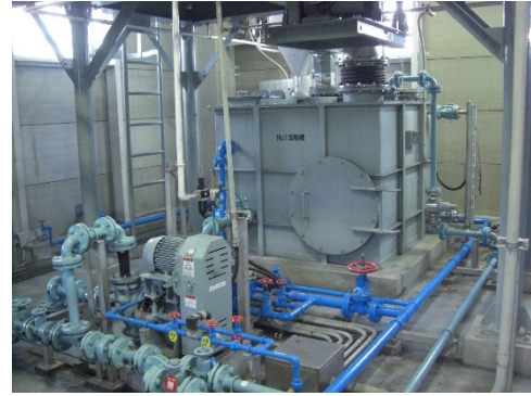
粉末活性炭注入設備
