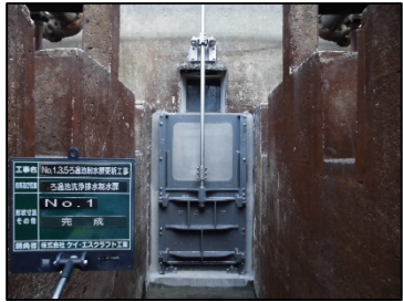
ろ過池の機械設備
