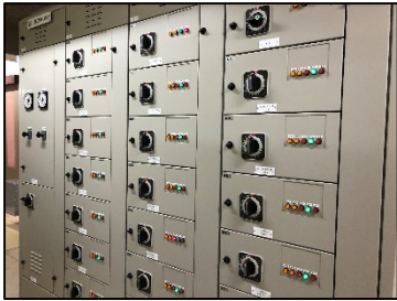
ろ過池の電気設備
