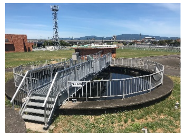
濃縮槽汚泥掻き機
