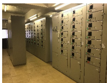
ろ過池電気設備
