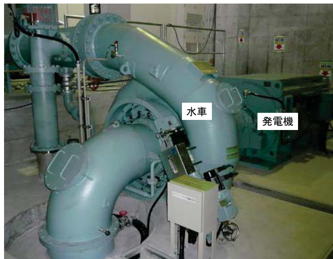
管理用発電設備
