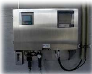
色度・濁度自動計測器（配水場）
