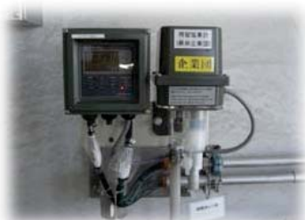
残留塩素自動計測器（配水場）
